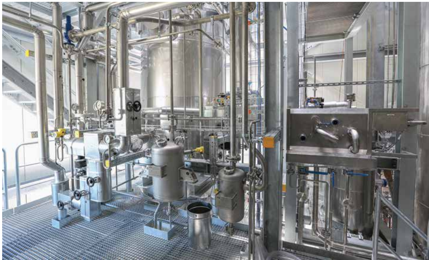
An industrial SPD plant supplied by VTA Verfahrenstechnische Anlagen GmbH & Co. KG Source: Nutriswiss
